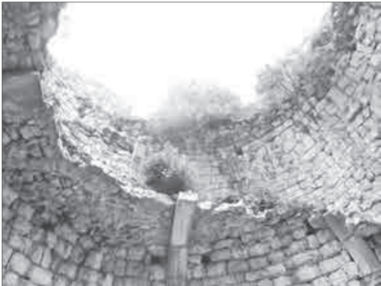
Верхняя часть башни со следами обрушения конструкций
