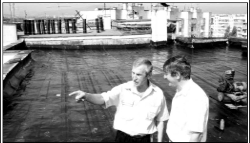
Житель дома на проспекте Кулиева Николай Бзиев (слева) поднялся на крышу, чтобы лично посмотреть как идет ремонт.
